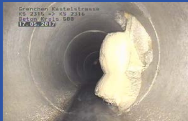
Verkalkter Abwasserkanal vor der Sanierung
