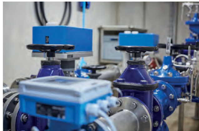
Armaturen im Innern des Messschachtes
