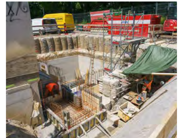
Der Gleichrichter in unmittelbarer Nähe zur bestehenden Trafostation
