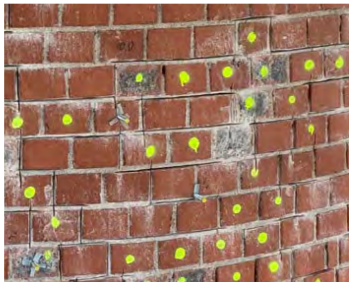
Markierte Steine, die ersetzt werden müssen
